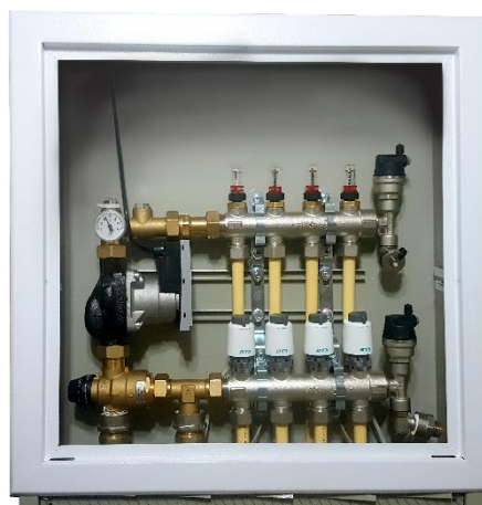
شکل ۲-۱۲ نصب کلکتورهای گرمایش از کف به همراه شیر سه راهه (Mixing Valve) و پمپ سیرکولاتور درون جعبه کلکتور شکل ۲-۱۳ استفاده غیر مجاز اتصالات گالوانیزه در سیستم گرمایش از کف
