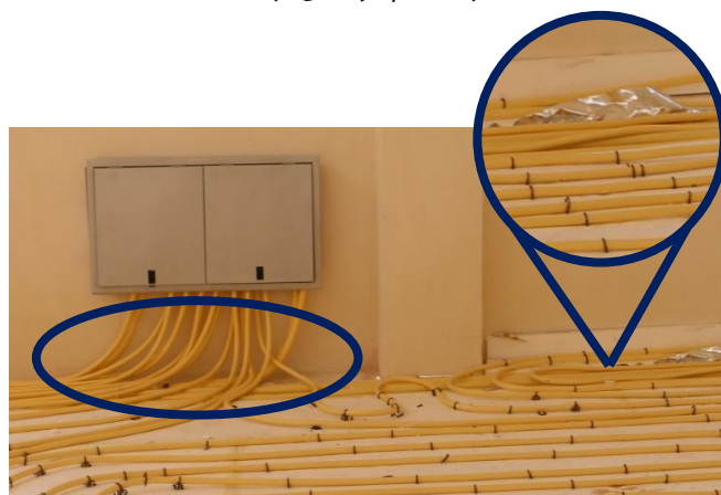
شکل ۲۰-۲ اجرای نامنظم و عبور لوله‌ها از روی یکدیگر
