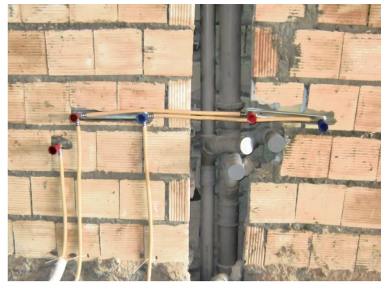
شکل ۱۹-۱ اجرای غلط - حرکت لوله به صورت افقی بر روی دیوار
