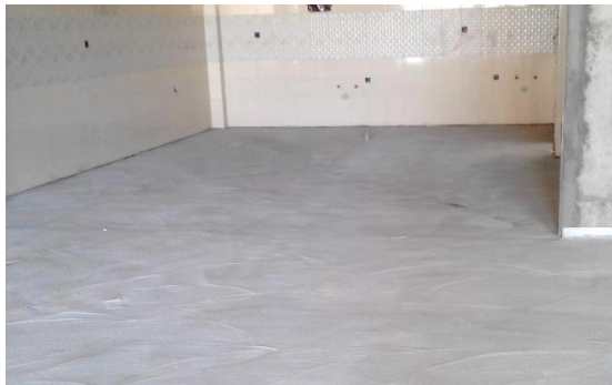
شکل ۷-۲ سطح صاف و تراز و عاری از هرگونه نخاله ساختمانی و آماده شده برای اجرای گرمایش از کف
