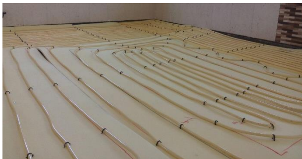
شکل ۸-۲ نمونه‌ای از تراز نبودن سطح قبل از عایق کاری و ایجاد برآمدگی بر روی لوله‌ها
